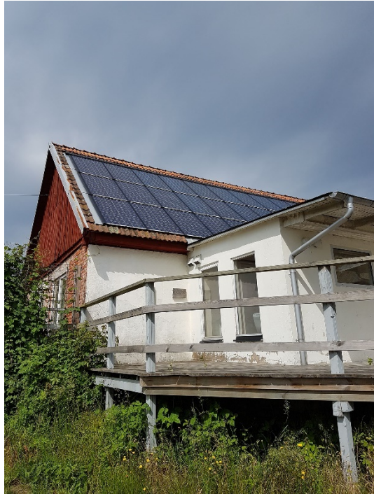
Bild 13. Solceller på taket till stallbyggnaden.
